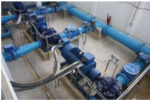
Nhà máy xử lý nước Malaysia
