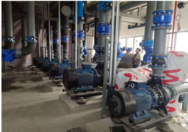
Xử lý nước
