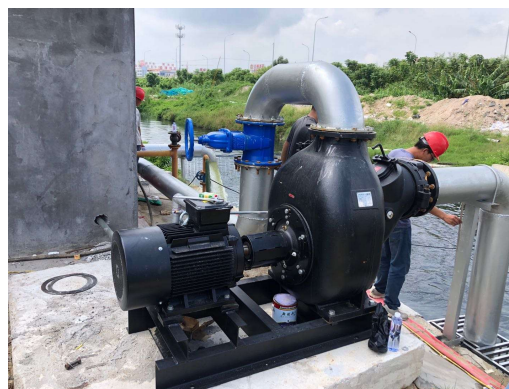
Hệ thống thoát nước khu dân cư
