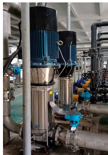
Bơm cao áp tòa nhà
