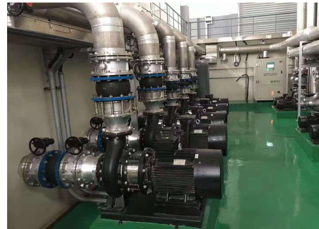
Hệ thống lọc
