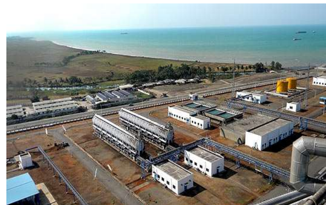
Nhà máy xử lý nước thải
